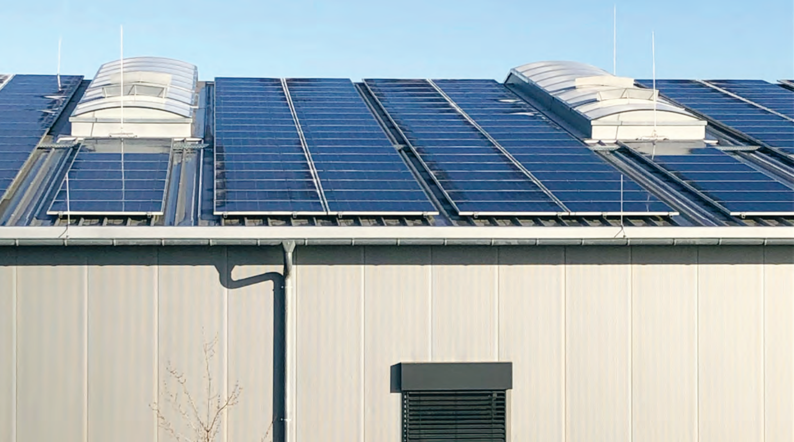
Fotovoltaikanlage auf dem Dach des Unternehmens Adelman zur Versorgung mit Eigenstrom – und Kostensenkung. (Bild: ECG)
