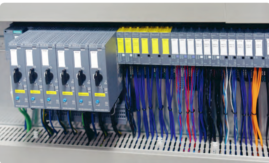
Thomas Eller sieht in Schaltgeräten mit hoher Funktionsintegration unter anderem Vorteile hinsichtlich Engineering, Beschaffung, Inbetriebnahme und Service. (Bild: Siemens)
