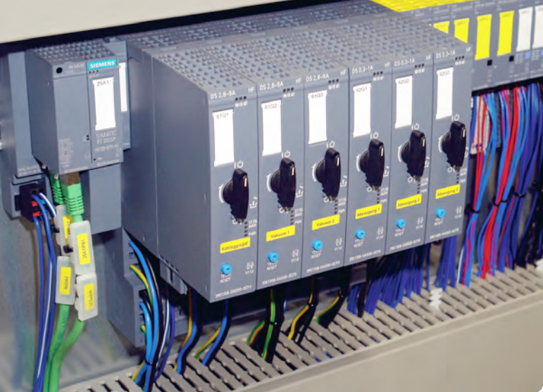
In der dezentralen Peripherie lassen sich Motorstarter und E/A-Einheiten (Standard und fehlersicher) individuell kombinieren und über Profinet in die Steuerungstopologie einbinden. (Bild: Siemens)
