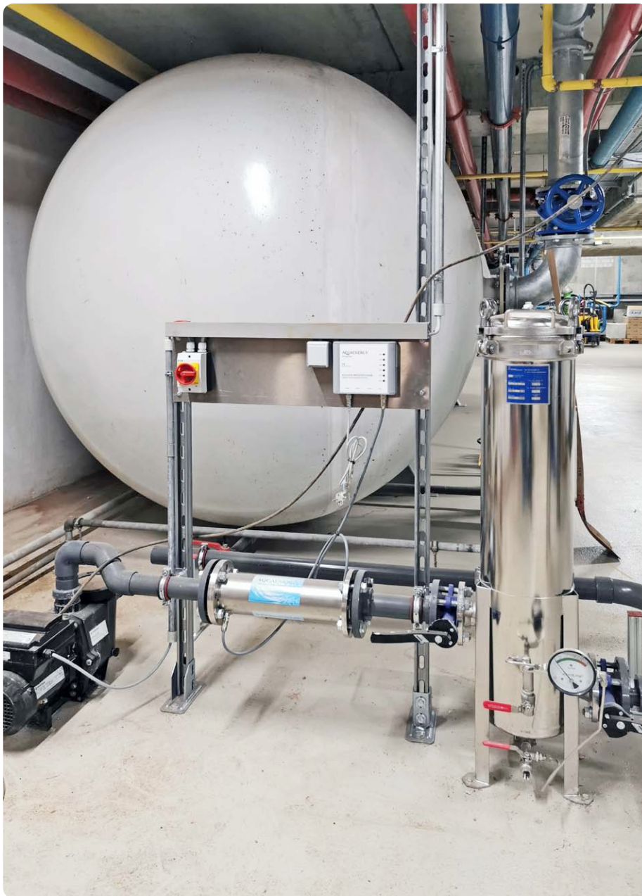
Typische Anlagenkonfiguration zur Filterung in Hydraulikkreisläufen. (Bild: Aquaenergy)
