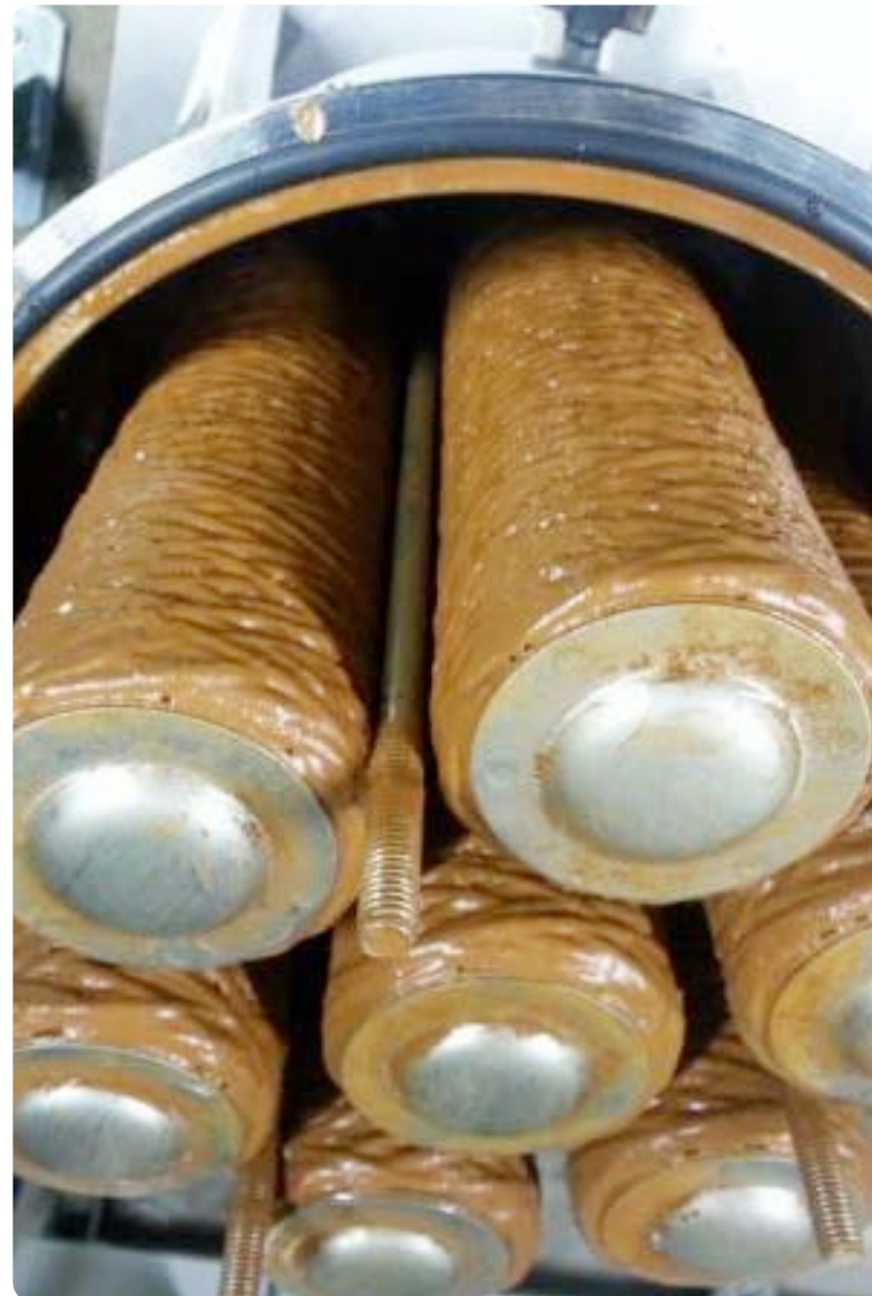
Abbau von Biofouling aus dem Kühlkreislauf einer Hydraulikkühlung. (Bild: Aquaenergy)
